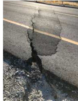
Figura 4.- Afección a la carretera coincidente con la medición de deformación ( Fuente: CHM ).
