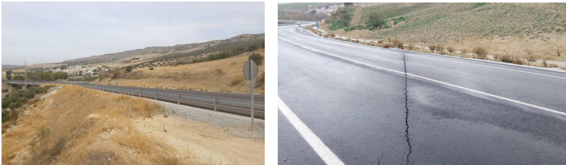
Figura 1 – Afección a carretera por movimiento de taludes (Fuente: CHM)
